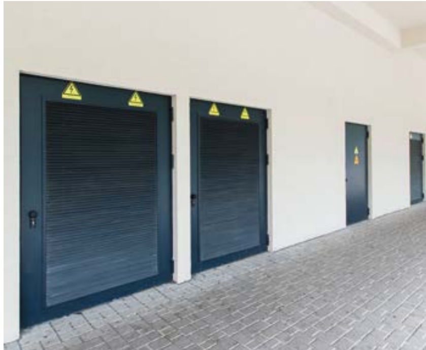
Mehrzwecktür mit Trafogitter
